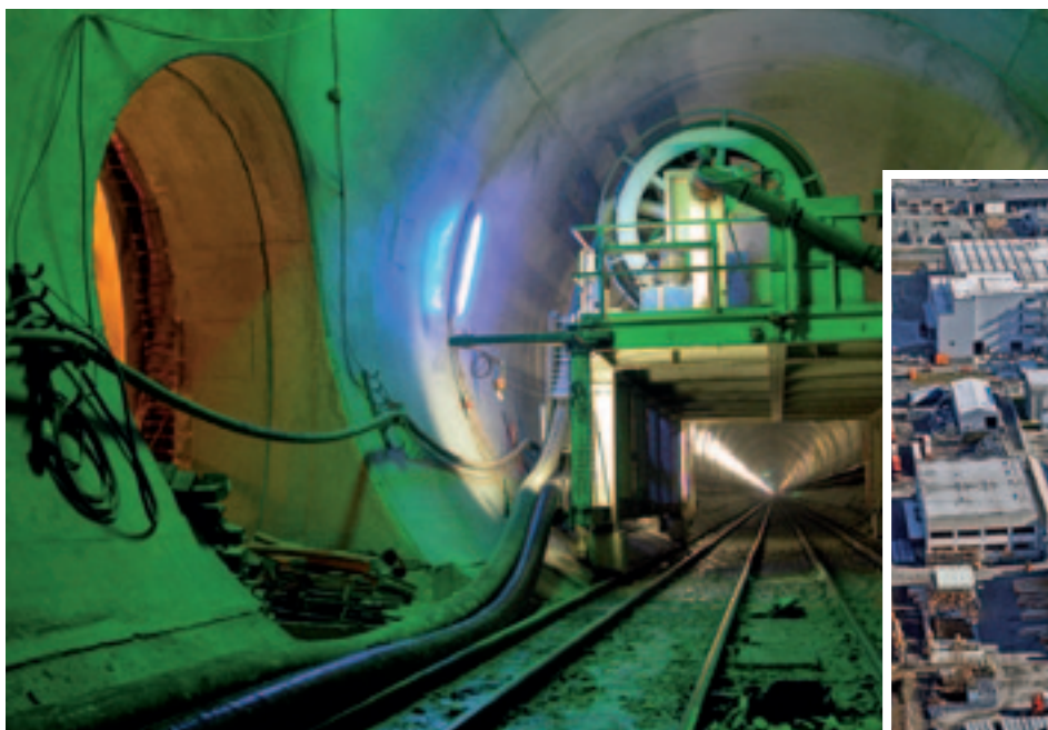
Nový 57 km dlhý Gotthardov tunel je znova dôležitým projektom Sika. Hoci je Sika-1 stále súčasťou nášho sortimentu, tentoraz bolo použitých množstvo nových, moderných výrobkov.
